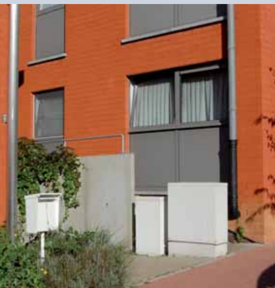
Des coffrets de raccordement regroupés qui minimisent leur impact sur l'espace public.
