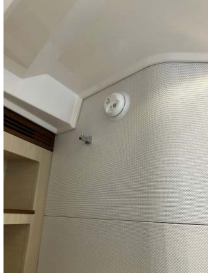
V-Berth CO/smoke detector
