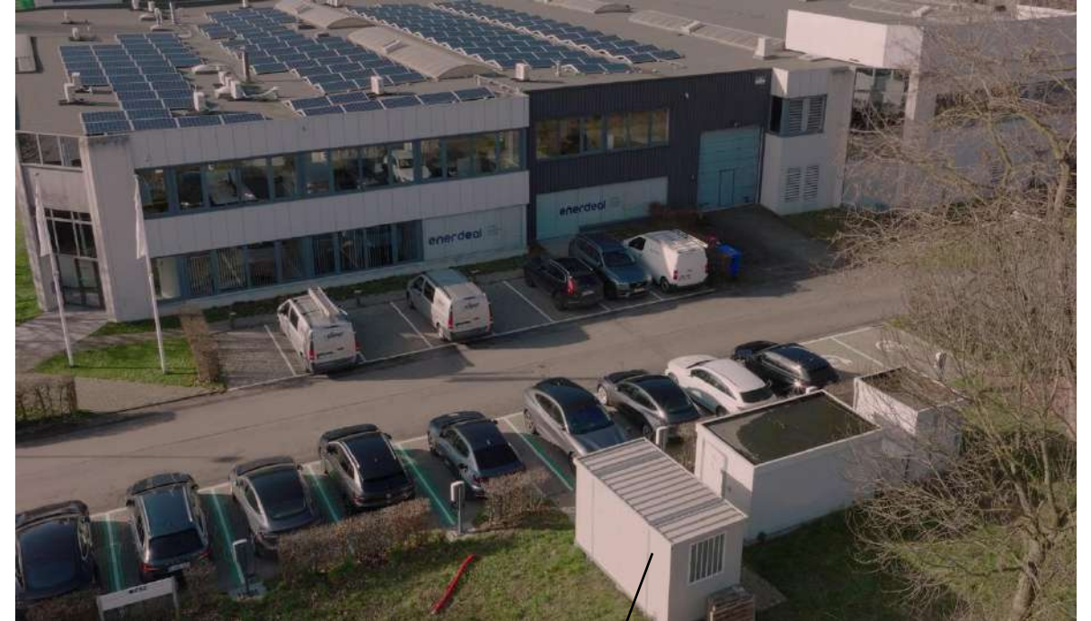
Batterie 50 kW, 130kWh
