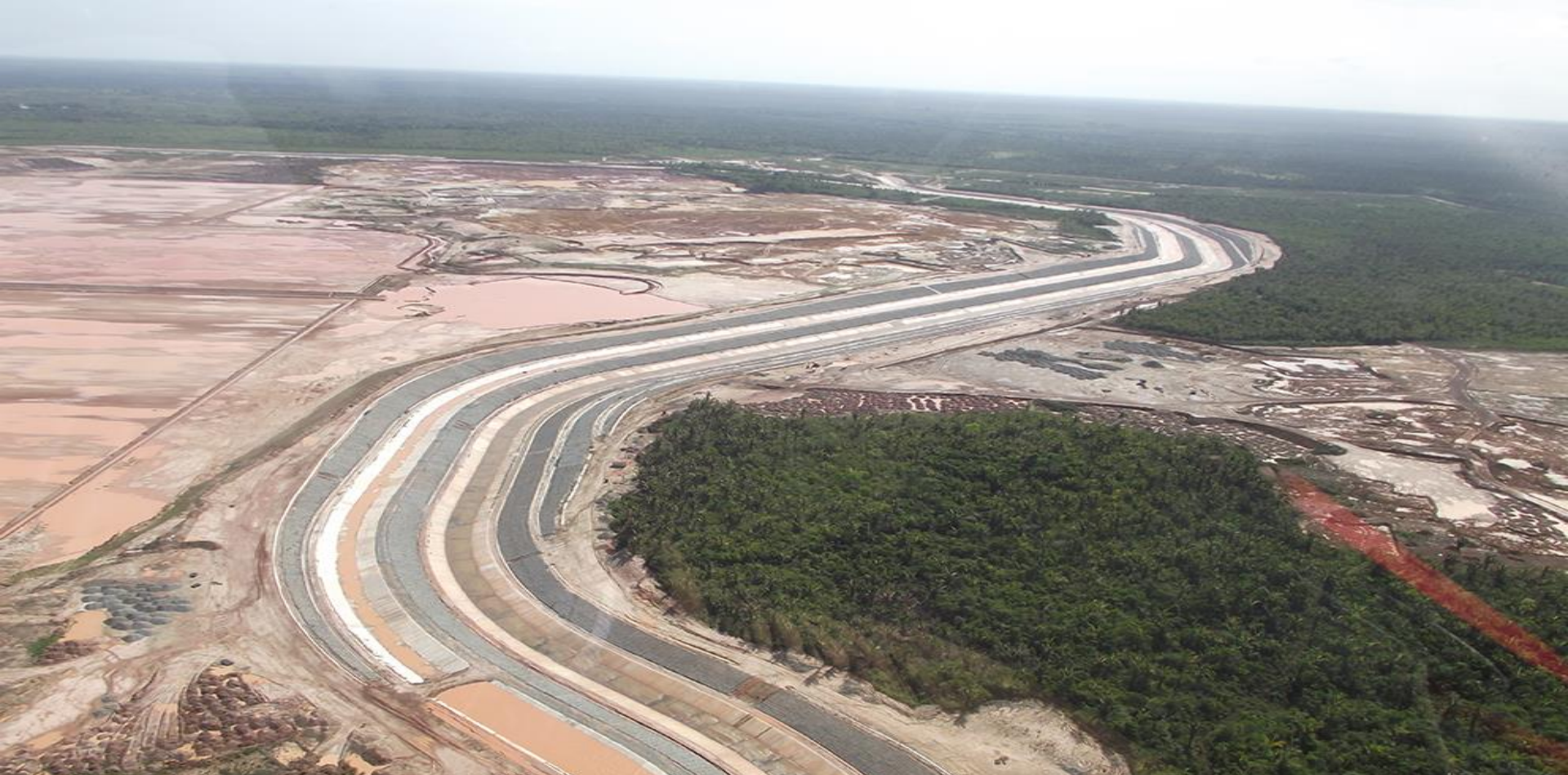
Canalización Trapezoidal, Brasil | Colchón Reno®
