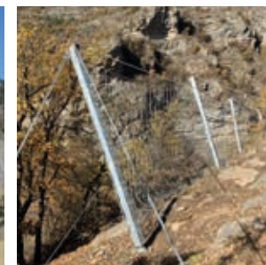
5 Écrans pare-blocs dynamiques
