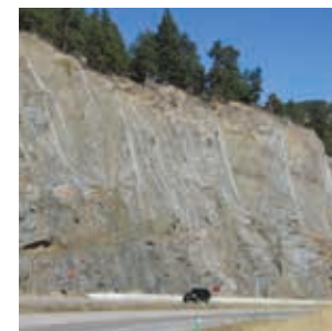
2 Systèmes de grillage et filets pare-éboulis - pendus
