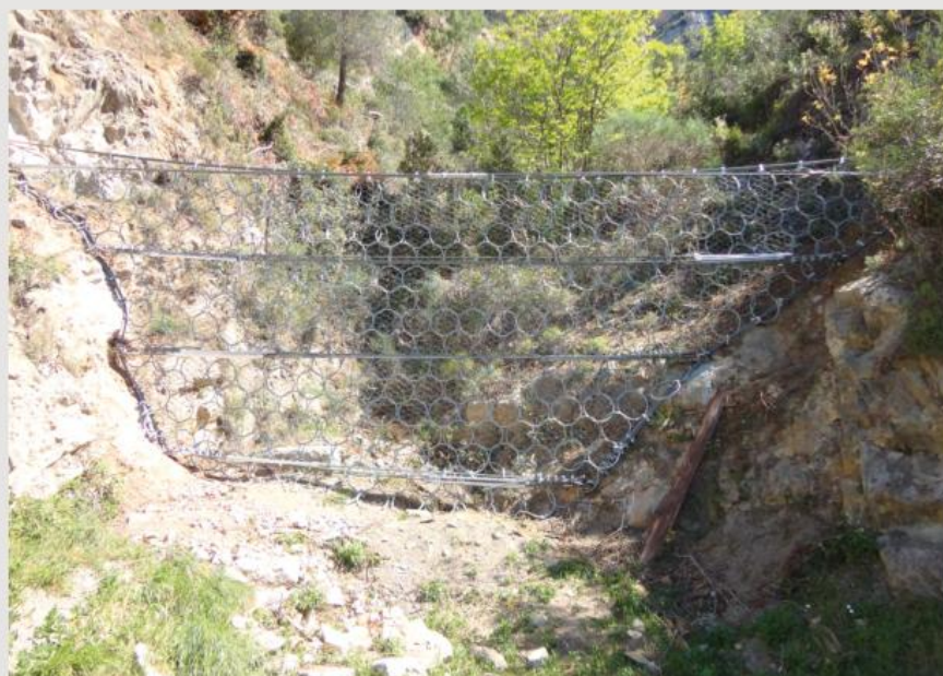
Barrières contre les laves torrentielles Maccaferri.
