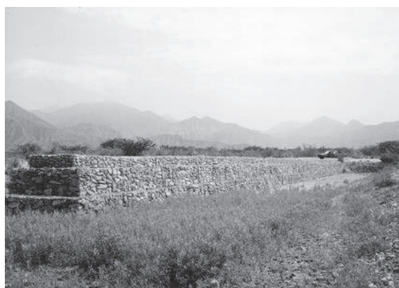
Figura 4.1.17 - Espigón en gaviones con plataforma antisocavación en Colchones Reno® después de algunos meses.
