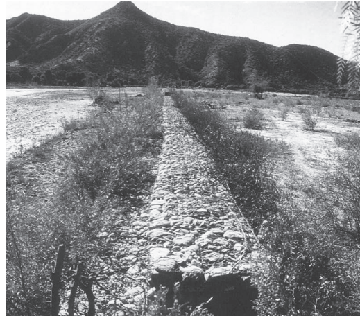
Figura 4.1.7 - Protección con vegetación contra la abrasión de espigones de gaviones.
