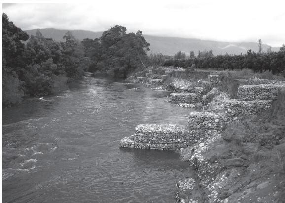
Figura 4.2.6 - Espigones en gaviones.
