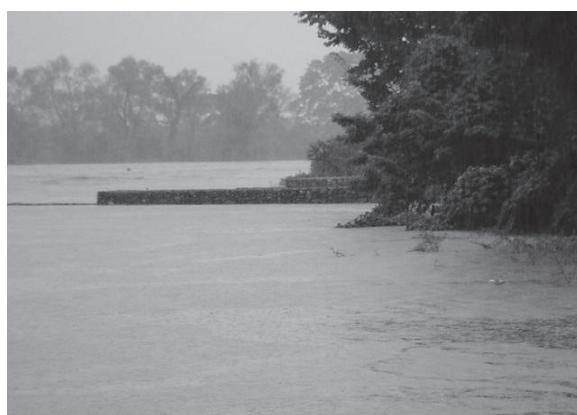
Figura 4.2.11 - Espigones en gaviones.
