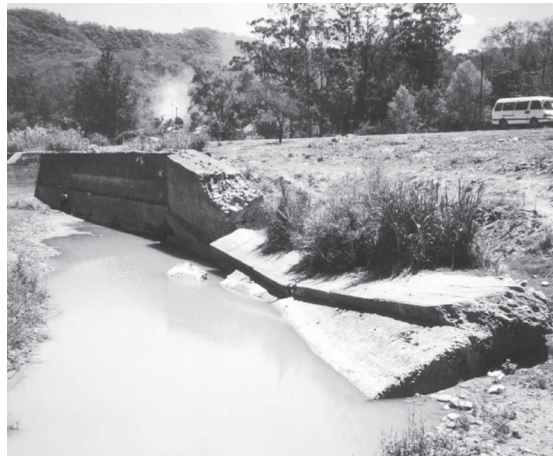
Figura 3.9.3 - Colapso del espigón de concreto por falla de la protección antisocavación.
