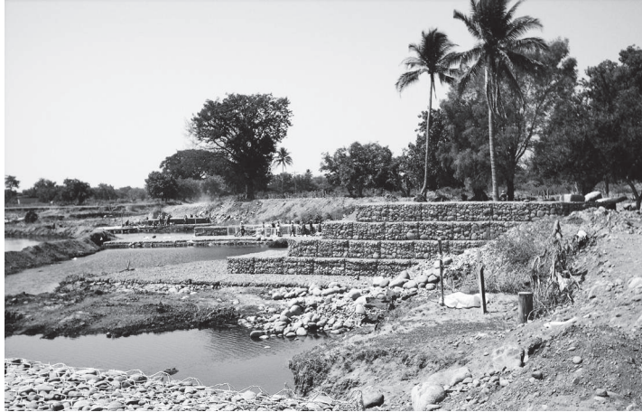
Figura 3.9.6 - Protección antierosión de espigón en gaviones.
