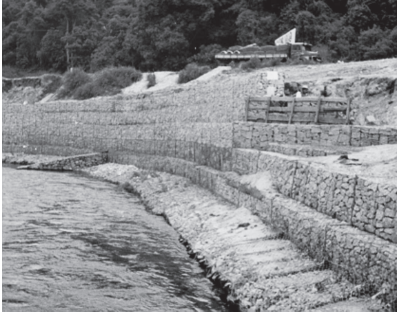
Figura 4.1.12 - Plataforma después de las primeras erosiones.
