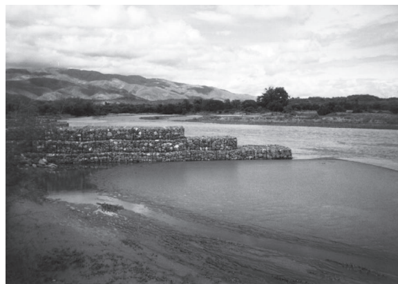
Figura 4.2.7 - Espigones en gaviones.
