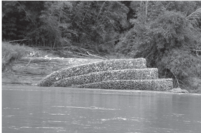
Figura 3.7.1 - Colapso del espigón de gaviones por falla del empotramiento.
