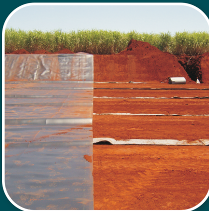
Reservatórios de vinhaça ou outros efluentes
