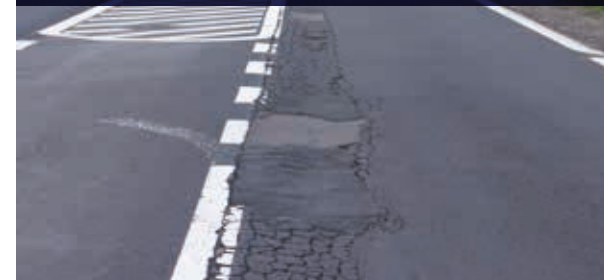
Fissuration liée à la fatigue
