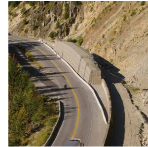
1 Barreras Estáticas contra desprendimiento de rocas y deslizamientos de suelo
