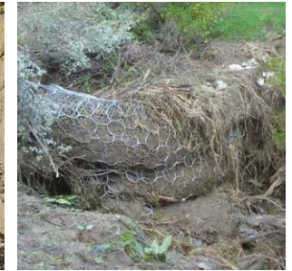
4 Barrera contra flujo de detritos y deslizamientos superficiales
