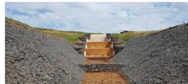
Escalera disipadora con Gaviones y Colchón Reno®
