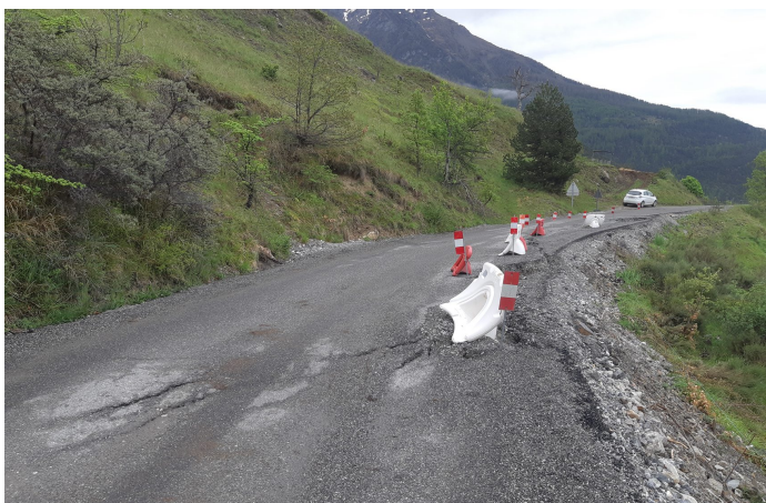
Vue du chantier avec affaissements et fissuration de la
