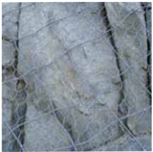
3 Systèmes de grillage et filets pare-éboulis- plaqués
