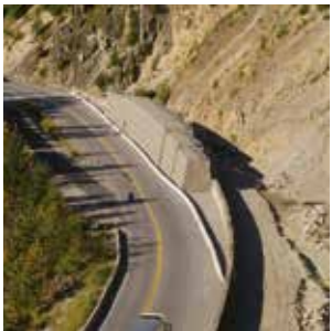
1 Merlons pare-blocs contre les éboulements et glissements de terrain
