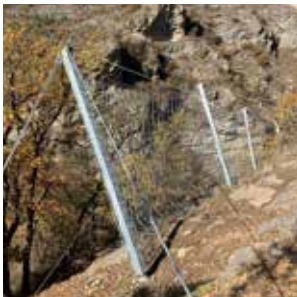
5 Écrans pare-blocs dynamiques
