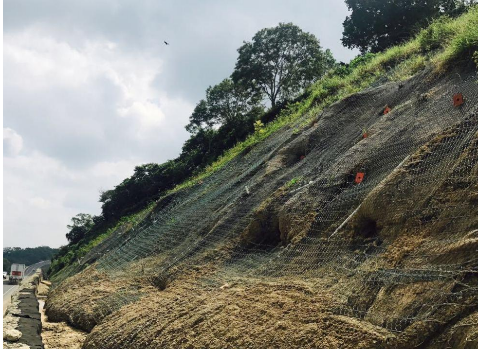
Retención de suelo fallado, no afecta la operación de la infraestructura
