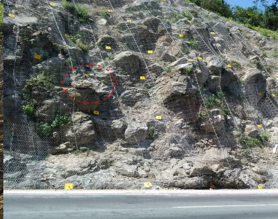
Retención de roca desprendida, no afecta la operación de la infraestructura
