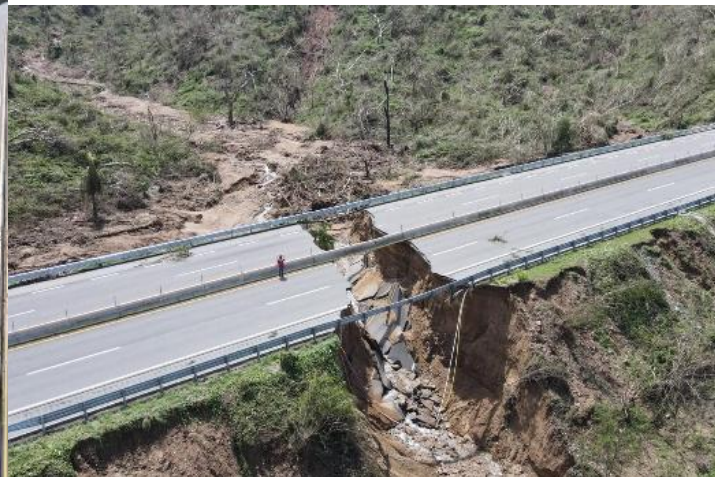
Obra de alcantarillado superada por el escurrimiento superficial
