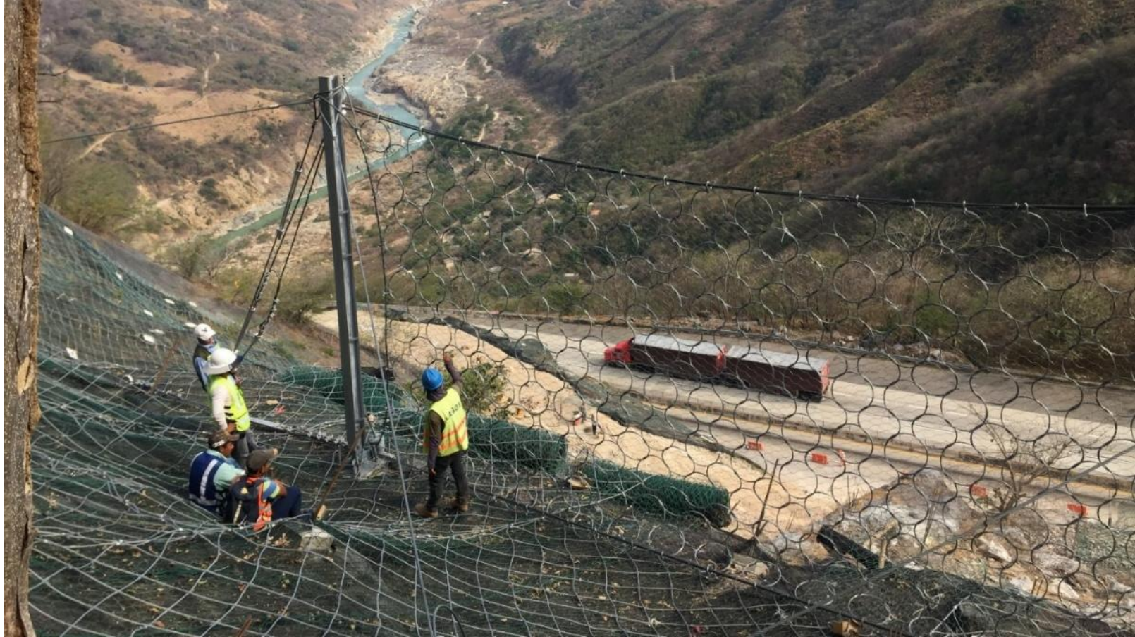
Barrera para el control de caidos Autopista Cuernavaca - Acapulco.
