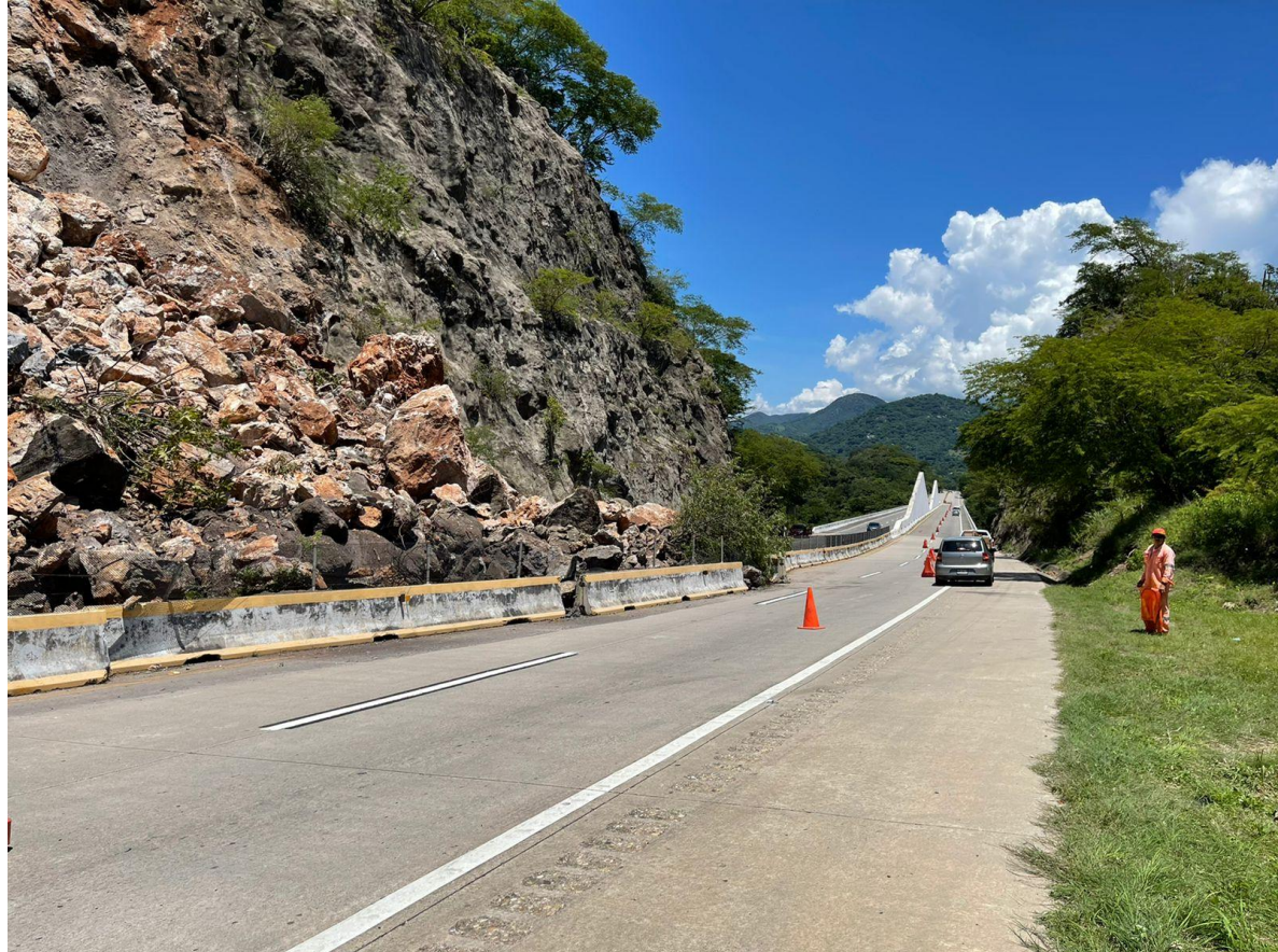
Falla de talud Km 326+800 autopista Cuernavaca-Acapulco, septiembre 2021
