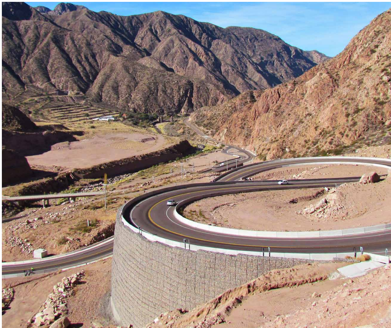
Contención en Suelo Reforzado
