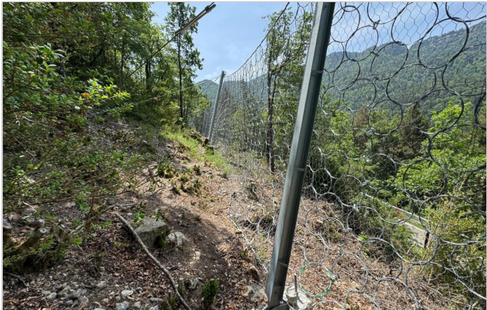
Barrera RB1500 vista desde el lado monte
