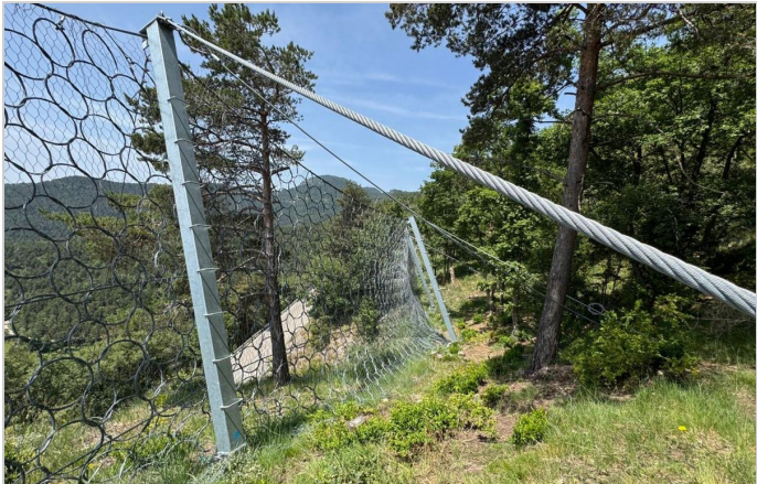
Barrera RB3000 vista desde el lado monte
