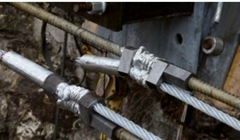
1 : Détail des dissipateurs d'énergie après impact
